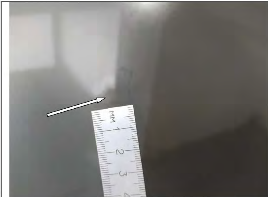
Фото №31. На стеклопакете оконно-дверного блока ПВХ в кухне имеется дефект (окалина).
