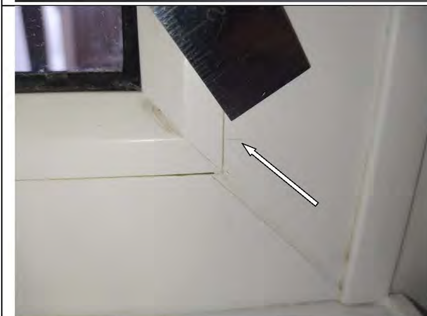
Фото №27. Профиль ПВХ оконно-дверного блока в кухне имеет дефекты (царапины).
