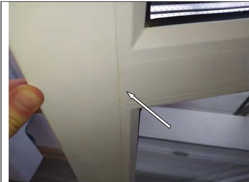
Фото №28. Профиль ПВХ оконно- дверного блока в кухне имеет дефекты (загрязнение малярными составами).
