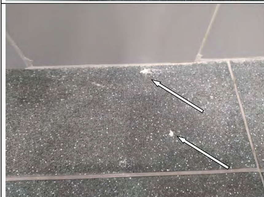
Фото №68. Загрязнение затирочным раствором напольной керамической плитки в ванной комнате.
