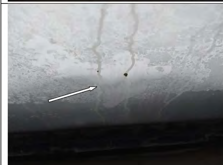
Фото №33. На стеклопакете оконного блока на балконе имеется дефект (загрязнение цементными растворами).
