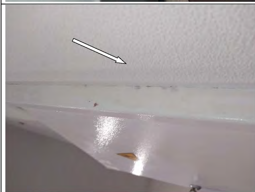
Фото №75. Следы поверхностной коррозии на электрическом щитке в прихожей.
