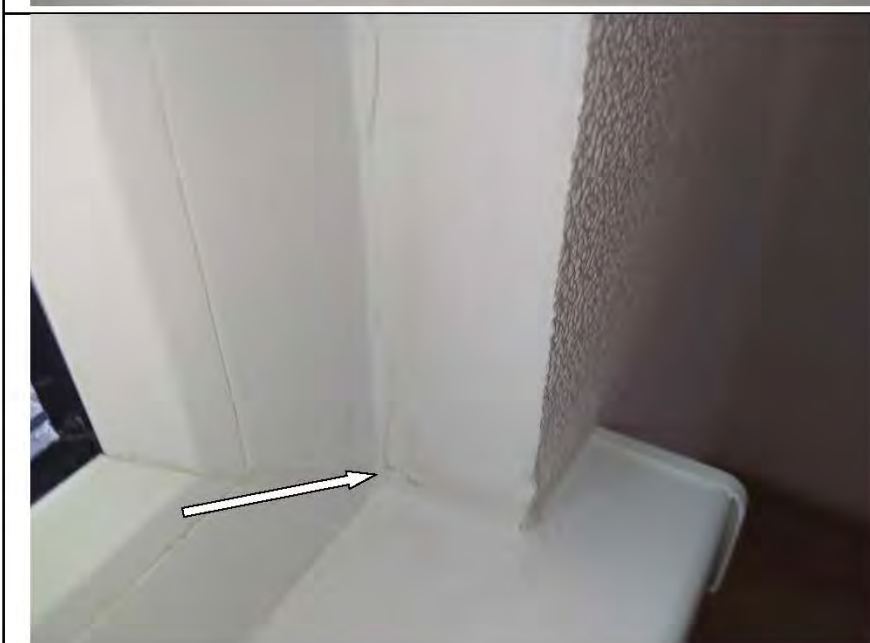
Фото №21. Оконный блок в спальне имеет щели, через которые происходит инфильтрация воздуха внутрь помещения.
