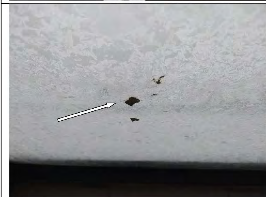
Фото №32. На стеклопакете оконного блока на балконе имеется дефект (загрязнение цементными растворами).
