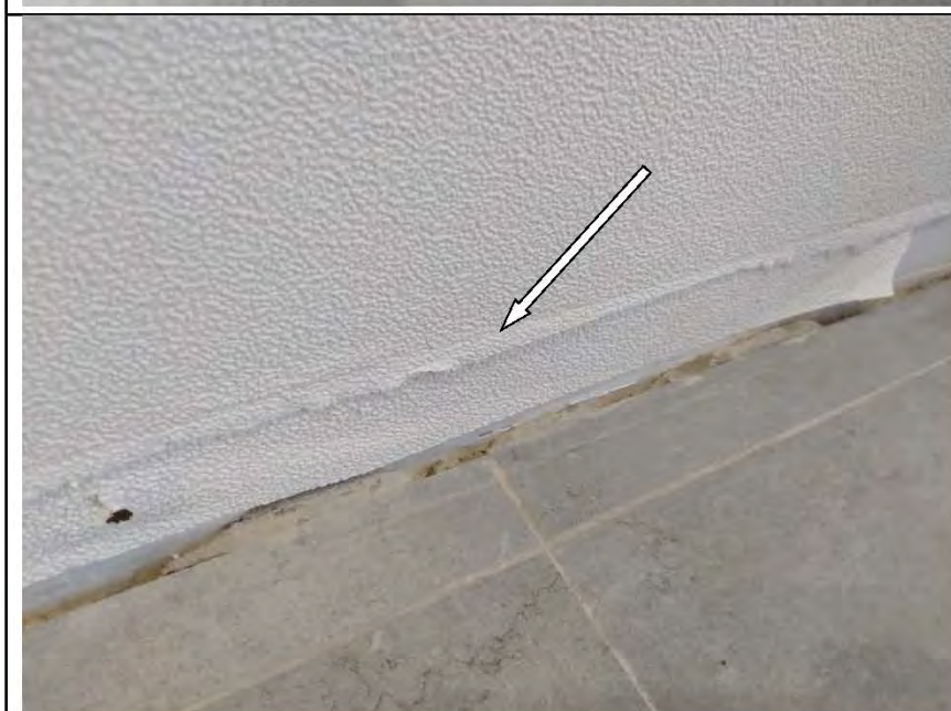
Фото №56. Доклейка обоев в прихожей выполнена с нарушением.
