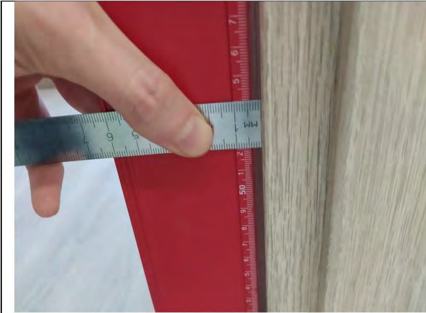
Фото №43. Отклонение коробки дверного блока в спальне.
