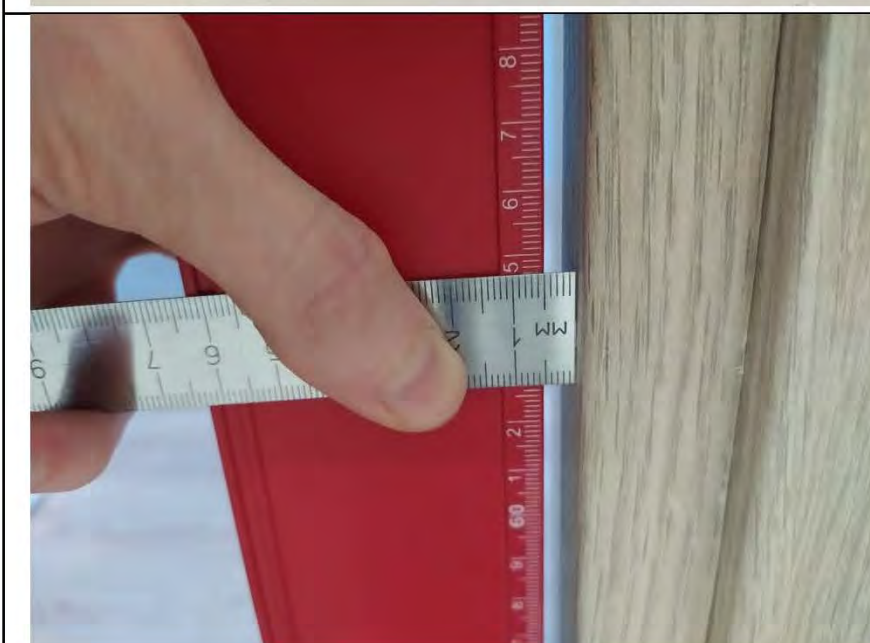
Фото №42. Отклонение коробки дверного блока в гостиной.
