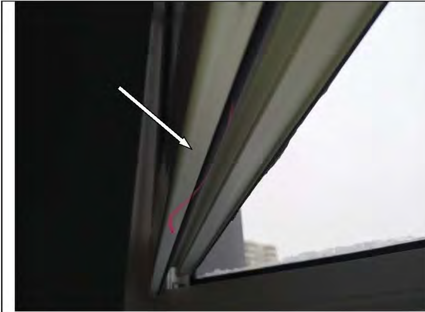
Фото №25. Профиль ПВХ оконного блока в гостиной имеет дефекты (царапины).
