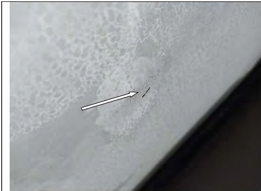
Фото №34. На стеклопакете оконного блока на балконе имеется дефект (загрязнение цементными растворами).
