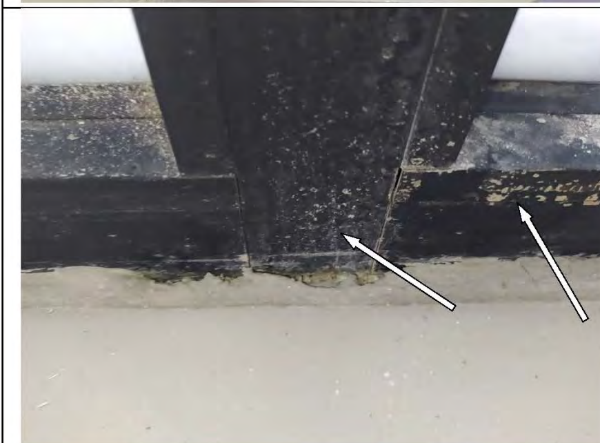
Фото №41. Дефект на металлическом профиле оконного блока на балконе (загрязнение).
