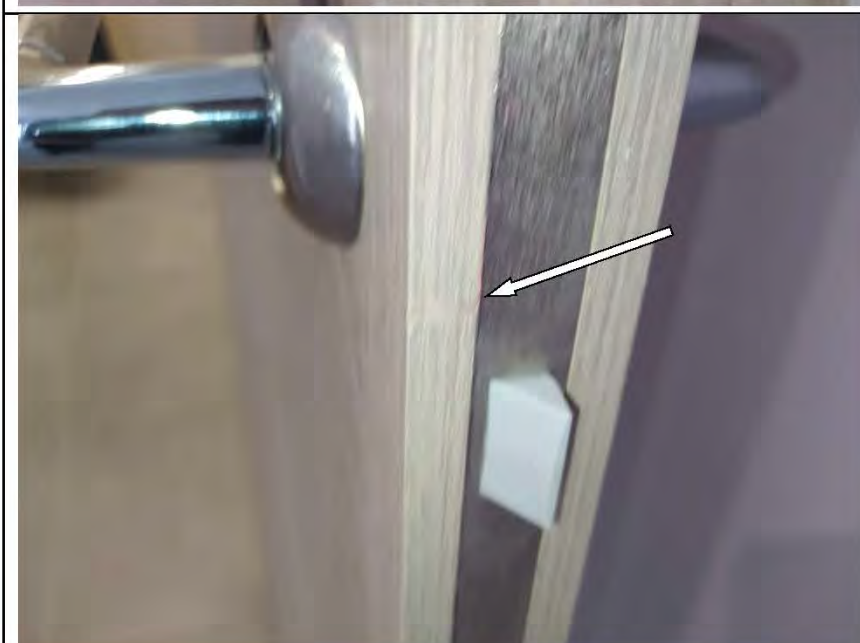
Фото №51. Дефекты (притертость) на лицевой поверхности полотна деревянного дверного блока в кухне.
