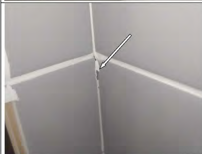
Фото №60. Затирка настенной плитки в ванной комнате выполнена с нарушениями.
