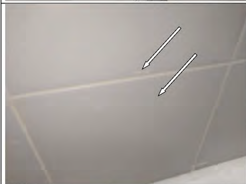
Фото №59. На настенной керамической плитке в ванной комнате имеются дефекты (загрязнения).
