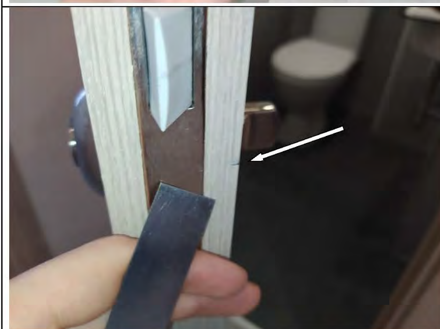
Фото №53. Дефекты (скол) на лицевой поверхности полотна деревянного дверного блока в санузле.
