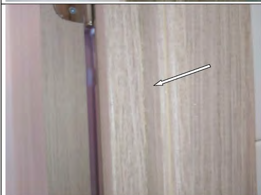
Фото №50. Коробка деревянного дверного блока в санузле имеет дефекты (загрязнение малярными составами).
