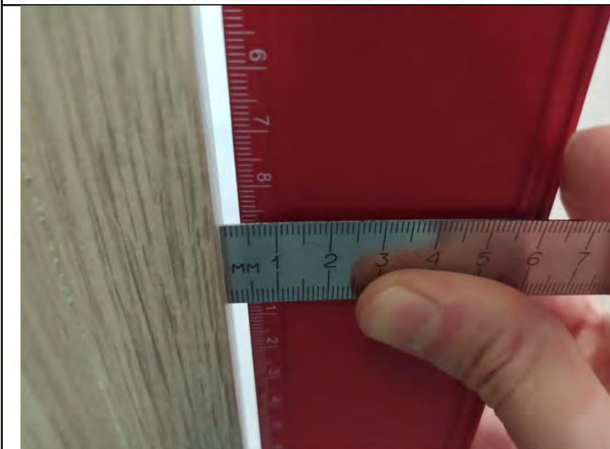
Фото №44. Отклонение коробки дверного блока в санузле.
