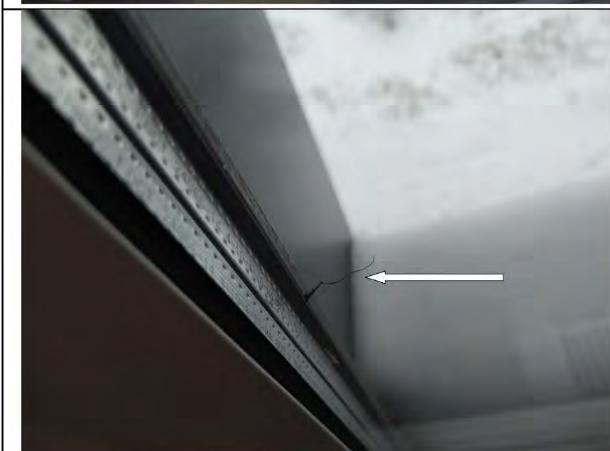
Фото №29. На стеклопакете оконного блока ПВХ в спальне имеется дефект (загрязнение герметиком).
