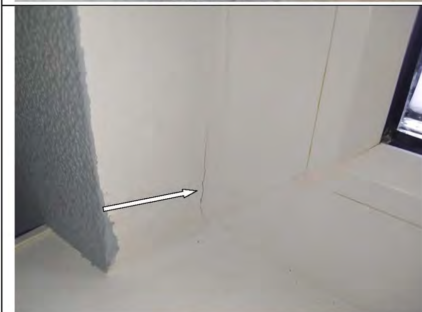
Фото №20. Оконный блок в гостиной имеет щели, через которые происходит инфильтрация воздуха внутрь помещения.
