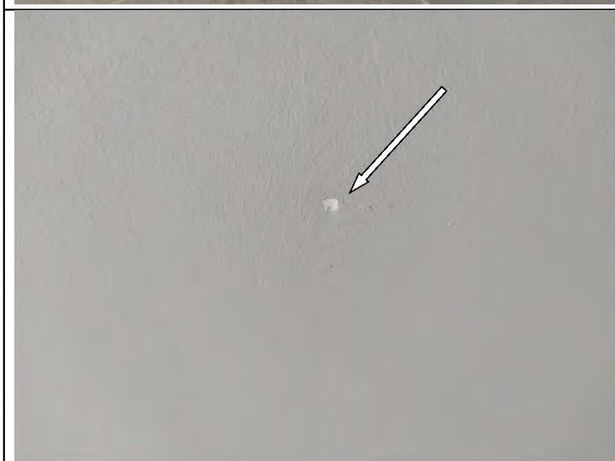
Фото №57. Шпаклеванные и окрашенные стены в балконе имеют дефекты (раковины).
