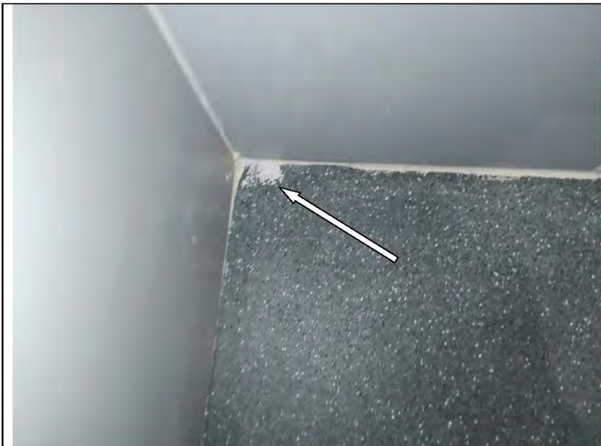
Фото №67. Загрязнение затирочным раствором напольной керамической плитки в санузле.
