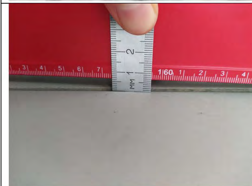
Фото №17. Измерения уровня напольного покрытия на балконе (керамическая плитка).
