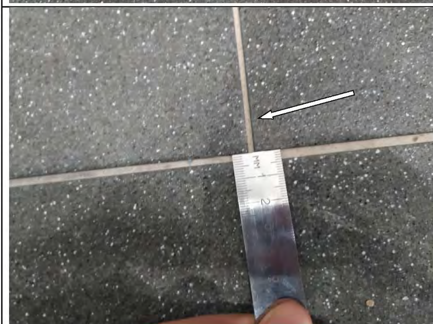
Фото №69. Затирка напольной плитки выполнена с нарушениями в ванной комнате: разность ширины шва.
