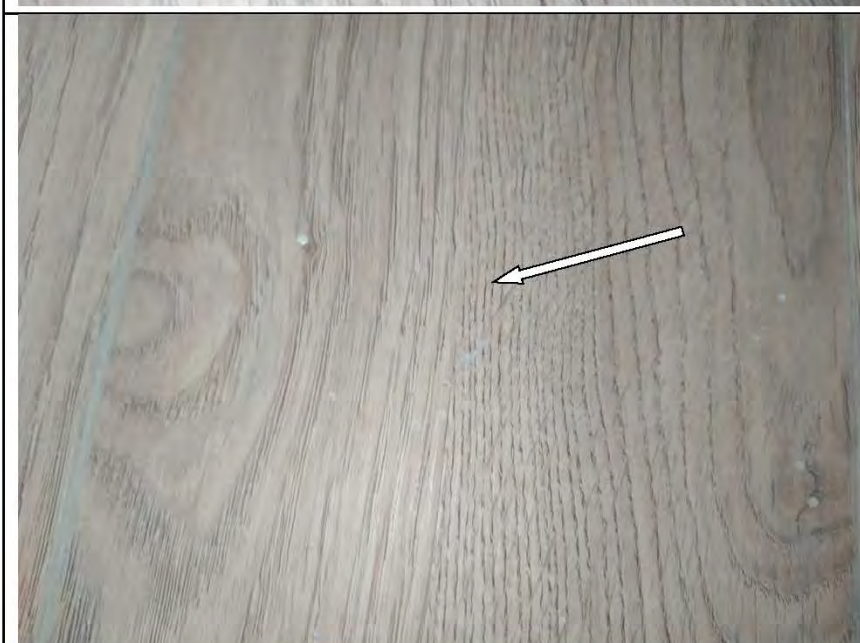
Фото №66. Механическое повреждение досок ламината в спальне.
