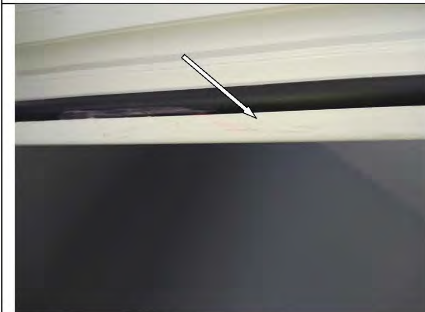
Фото №26. Профиль ПВХ оконного блока в гостиной имеет дефекты (царапины).
