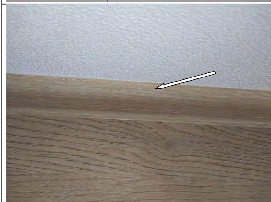
Фото №62. Загрязнение напольного плинтуса ПВХ в спальне.
