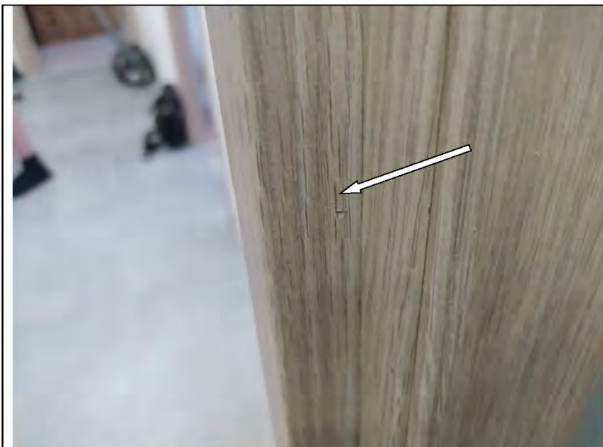
Фото №49. Коробка деревянного дверного блока в ванной комнате имеет дефекты (царапина).
