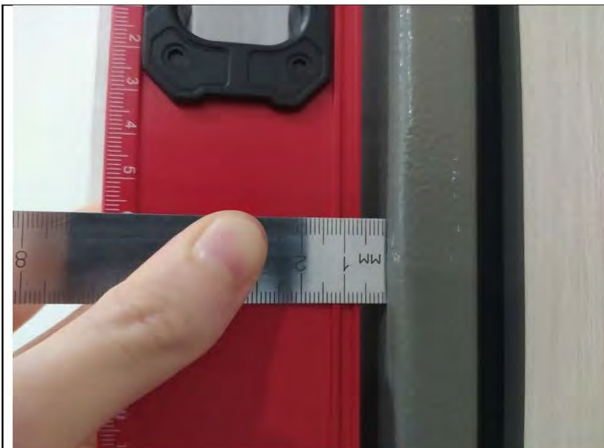
Фото №73. Отклонение коробки входного дверного блока
