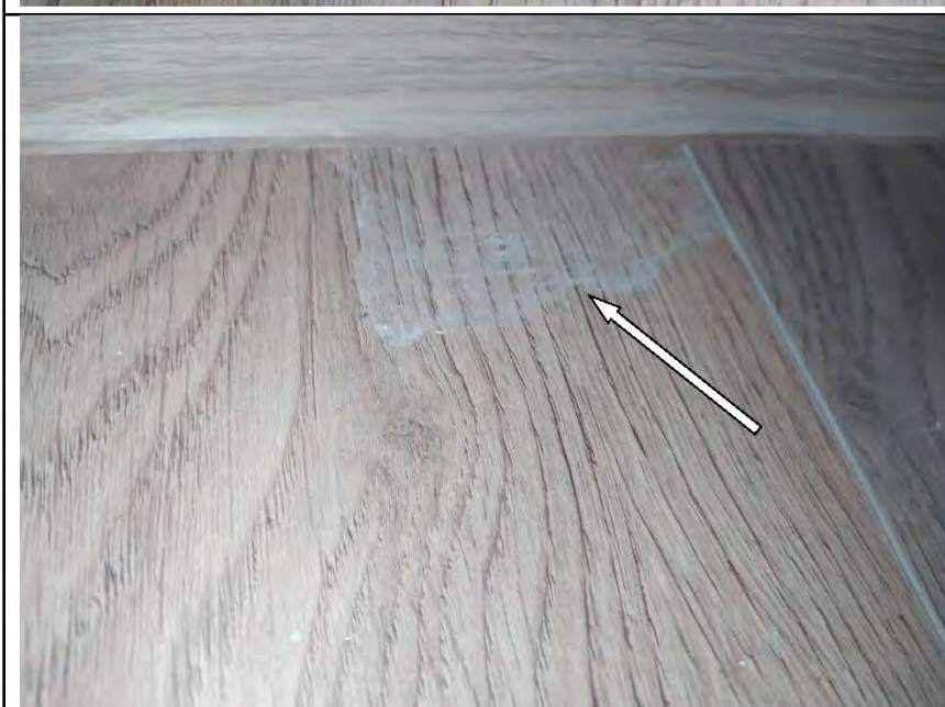
Фото №65. Загрязнения на поверхности ламината в спальне, в гостиной.
