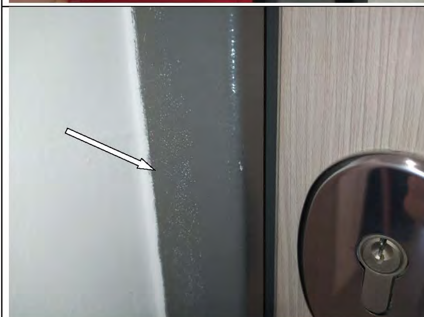
Фото №74. Коробка входной металлической двери имеет дефекты (загрязнение малярными составами).
